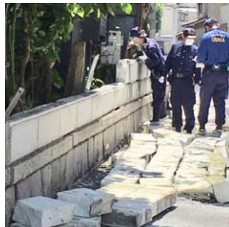
▲事故直後の石積塀倒壊現場
